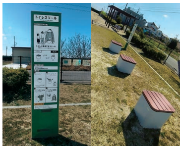
▲マンホールトイレ(祠峯公園)
